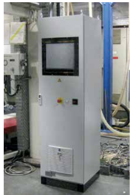
Neuer Schaltschrank einsatzbereit
