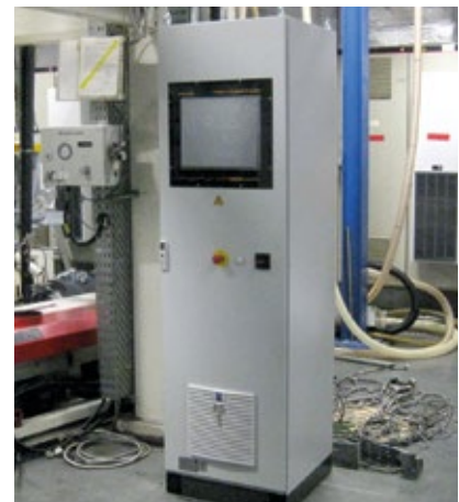
Neuer Schaltschrank einsatzbereit
